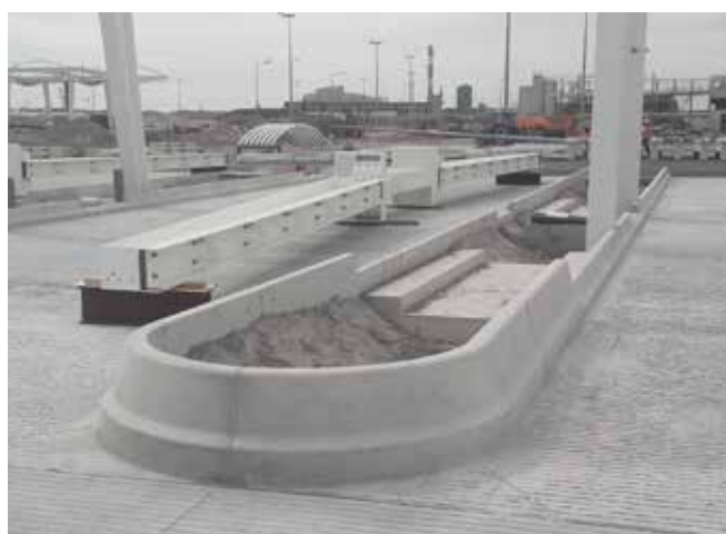
Éléments BUSWAY® et MINIGUID, Port de Calais
